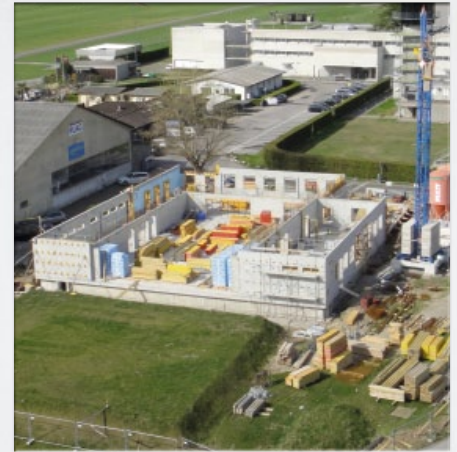
Aprile 2012, torna il sereno sul cantiere della nuova base in Ticino e i lavori riprendono spediti.
