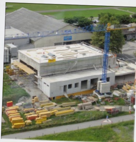
Agosto 2012, finalmente a tetto! Ma ci vuole ancora un po' di pazienza prima di festeggiare.
